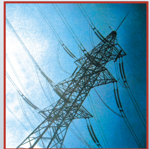
Повітряна лінія електропередачі 110 кВ
