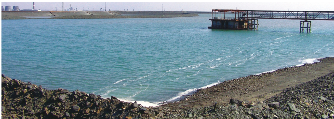
Водозабірна споруда (ПАТ «АрселорМіттал Кривий Ріг»)
