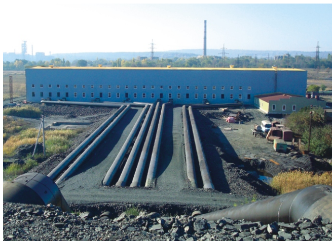
Насосна станція оборотного водопостачання (ПАТ «Північний ГЗК»)
