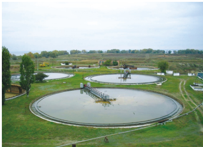
Каналізаційні очисні споруди. Радіальні відстійники (м. Черкаси)
