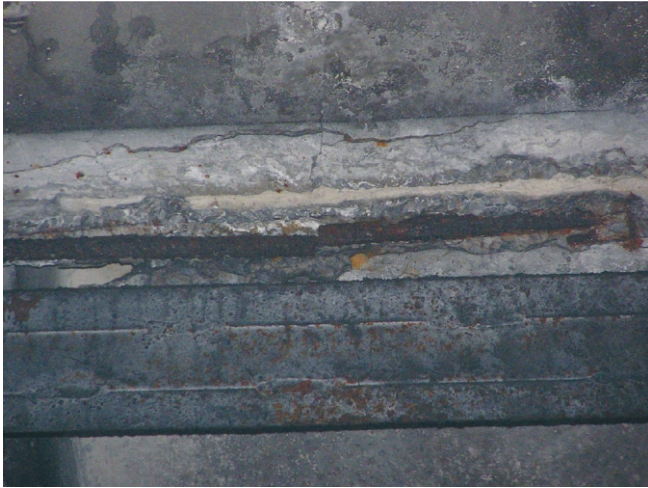
Рис. 1. Разрушение нижней поверхности плиты покрытия с оголением и разрывом арматуры в продольных ребрах
