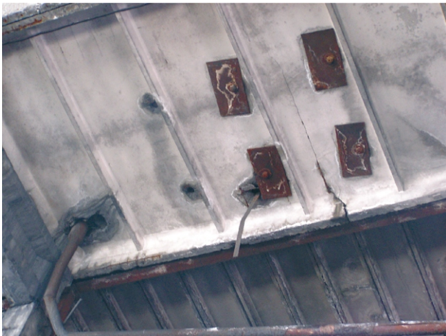
Рис. 2. Вертикальная трещина шириной до 15 мм, переходящая в полку предварительно напряженной плиты покрытия
