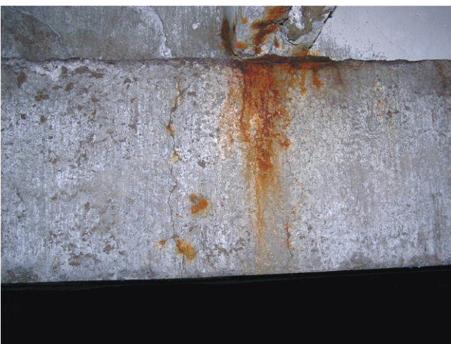
Рис. 3. Вертикальная трещина шириной до 1,5 мм на боковой поверхности балки перекрытия
